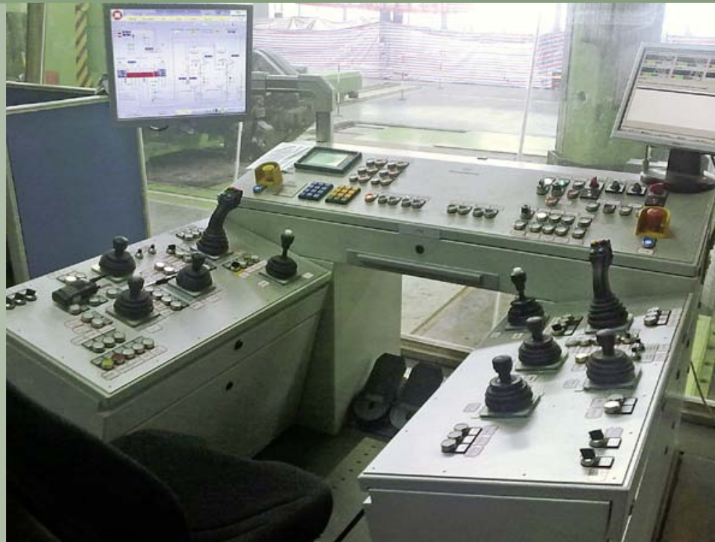
...Pressensteuerung nach dem Umbau
