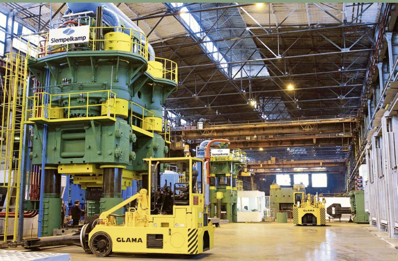
Die beiden ertüchtigten Pressen
