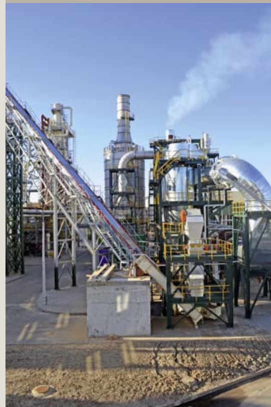
Spänetrockner und Nasselektrofilter
