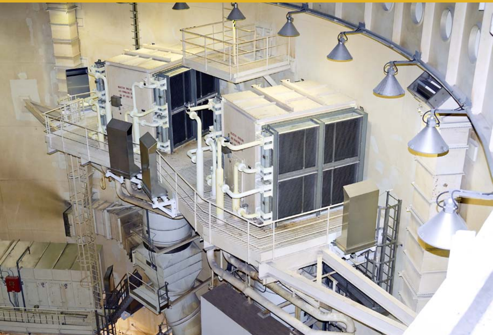
NIS-PAR-Module eingebaut im Reaktorgebäude des KKW Krško/Slowenien
