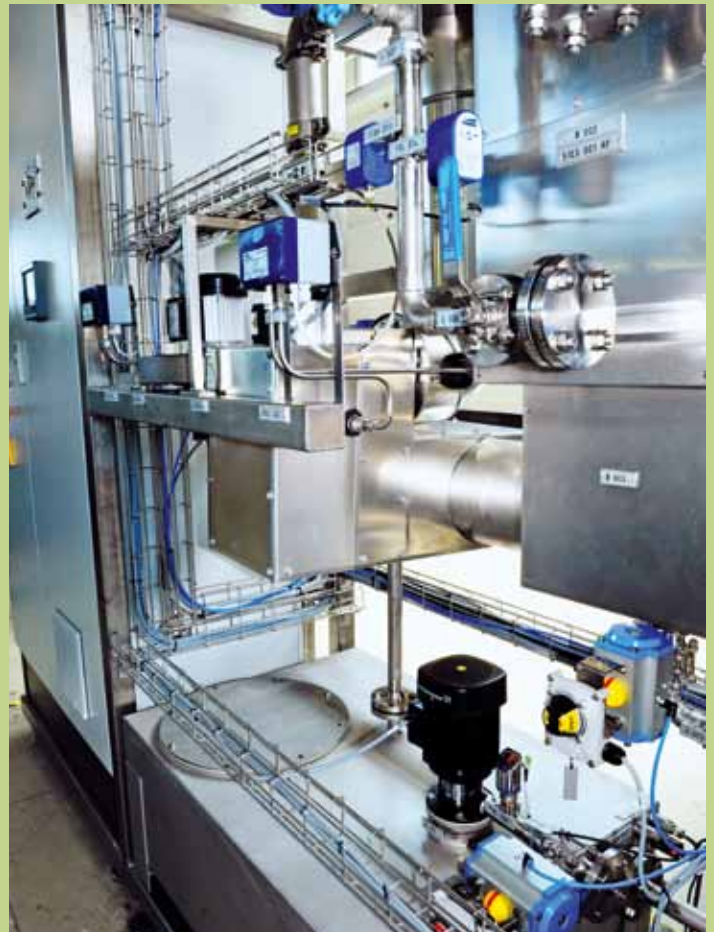
Links: Unterdrucksystem der Trockneranlage, rechts: Kaltwassersystem zur Kondensatabscheidung der Trocknungsabluft
