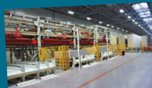
Stapelboxen mit Rohplattenlager zur Beschickung der KT-Press
