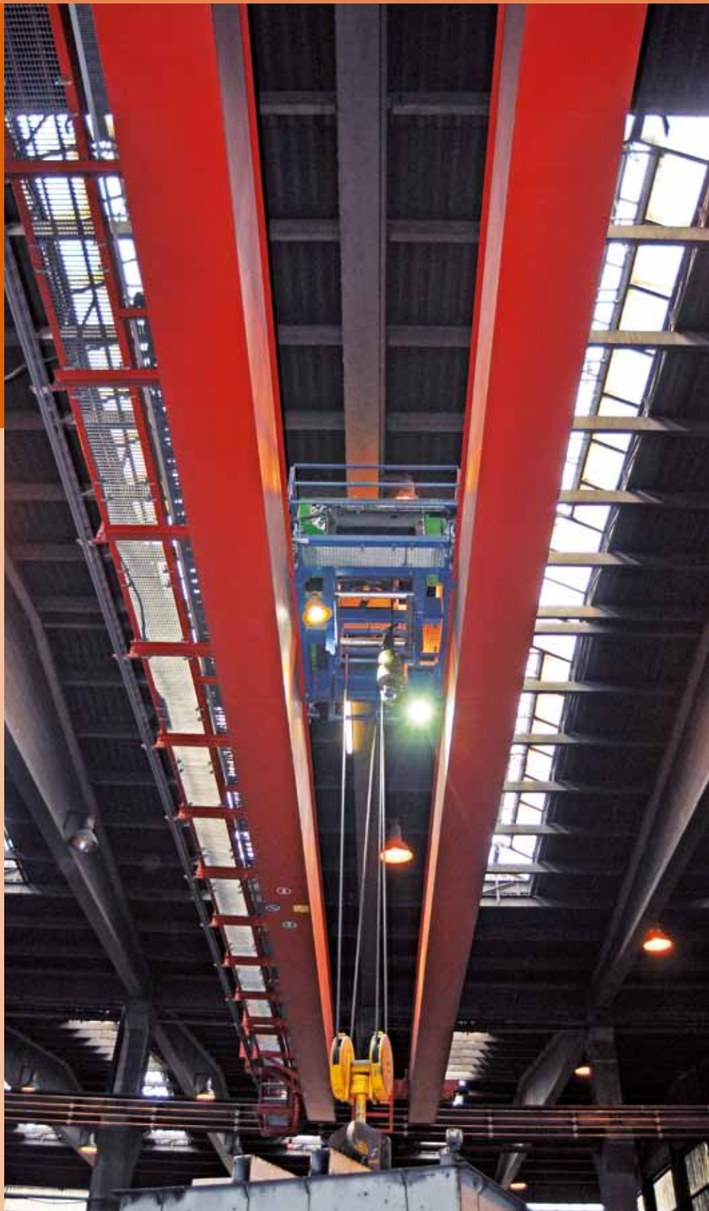
SGL Group, Meitingen, Bereich Ringofen: SKT-Zweitträger-Brückenkran mit Sicht auf die Katzfahrwerke und Lastaufnahme
